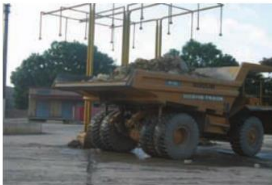
Hình 40. Hệ thống phun nước tự động tại Nhà máy xi măng Hoàng Thạch
